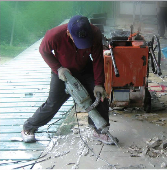
햄머드릴을 이용해 시공이 어렵고 불편함
