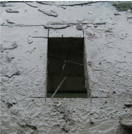
깨끗하게 뚫기가 어렵고 철근 및 전선이 파손됨.
