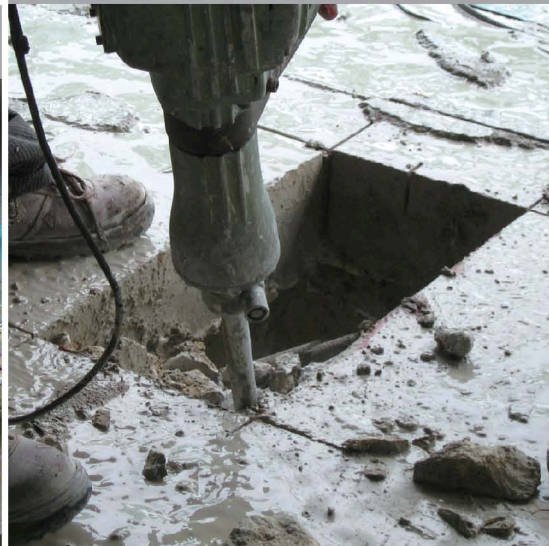
시공시 건물에 균열이 생기고 안전문제가 생김
